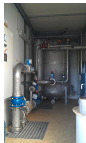
Système de déferrisation / filtration
